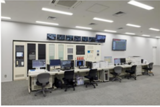
▲防災センター
